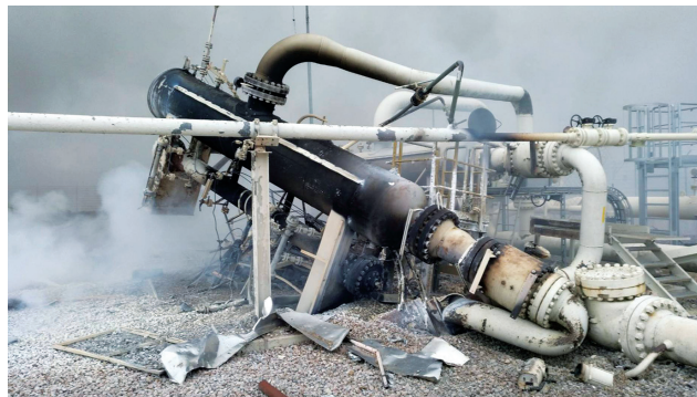
Фотография 1 – Взрыв на трубопроводе
